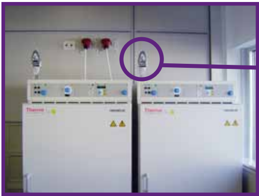
Controllo della temperatura su Stufe
