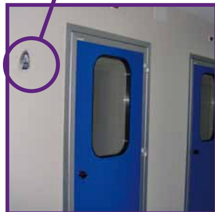
Controllo di temperatura e umidità in camere bianche
