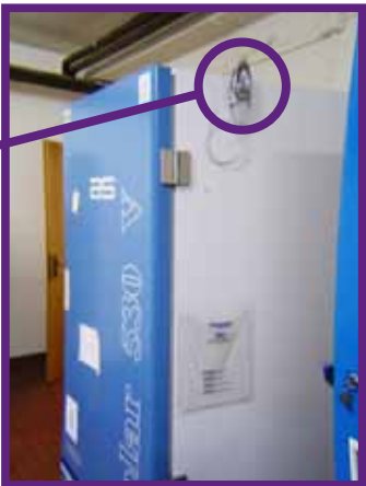
Controllo della temperatura su congelatore -80°C
