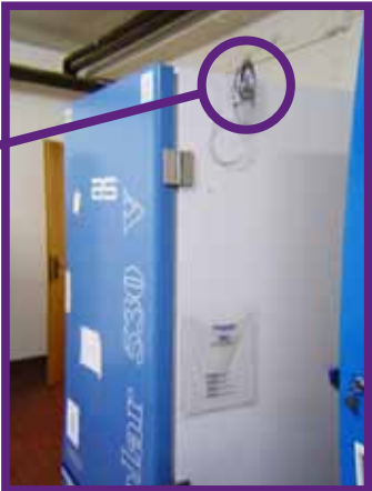
Controllo della temperatura su congelatore -80°C
