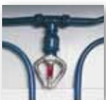
1 Un' ulteriore sicurezza data da uno sprinkler che in caso d'incendio libera il liquido dello scambiatore.
